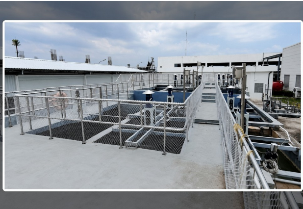
Toàn cảnh cụm bể công nghệ và sàn thao tác
