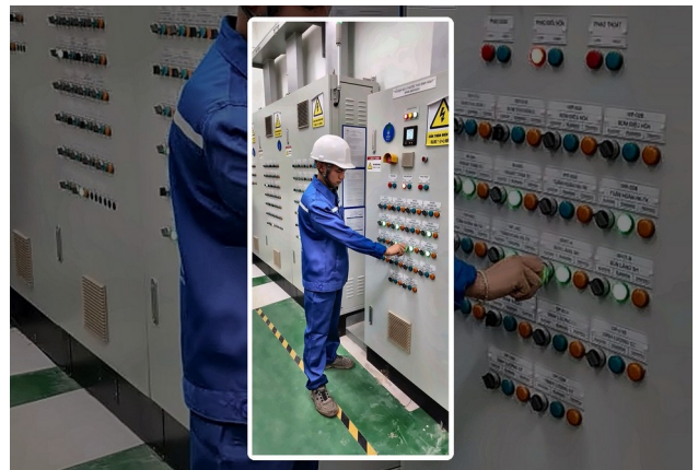
Vận hành tủ điện hệ thống xử lý nước thải sinh hoạt
