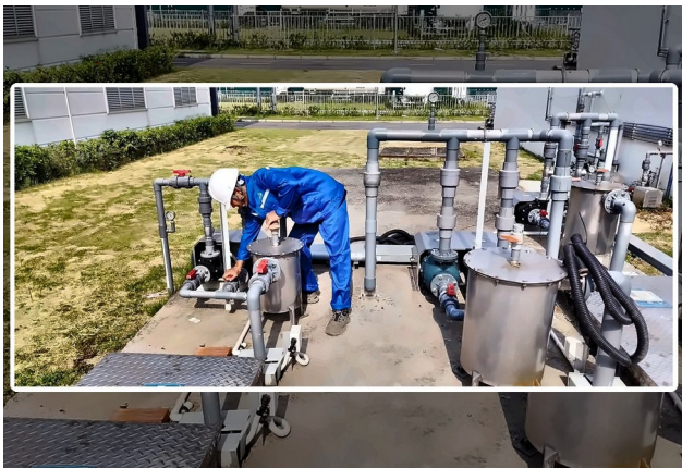
Kiểm tra bơm, lọc và đường ống công nghệ
