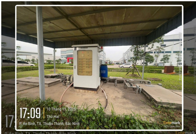
Tủ điện, bơm và đường ống công nghệ dưới mái che
