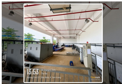
Toàn cảnh sàn vận hành và tủ điện điều khiển
