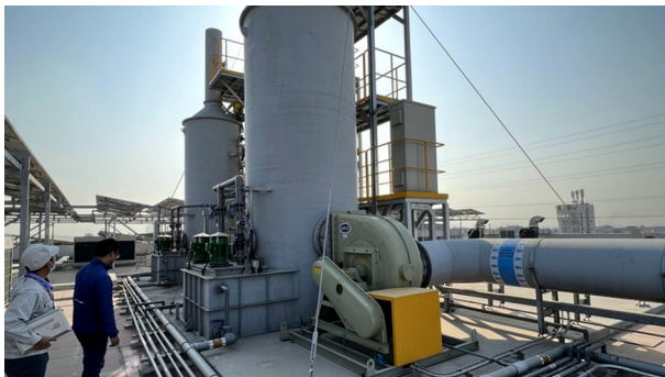
HỆ THỐNG XỬ LÝ KHÍ THẢI
