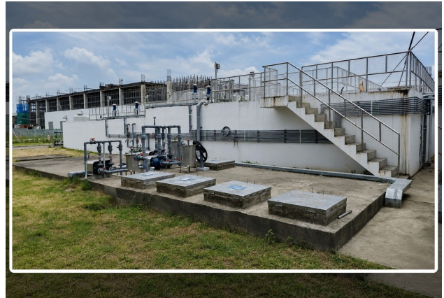
Cụm thiết bị, đường ống và cầu thang vận hành
