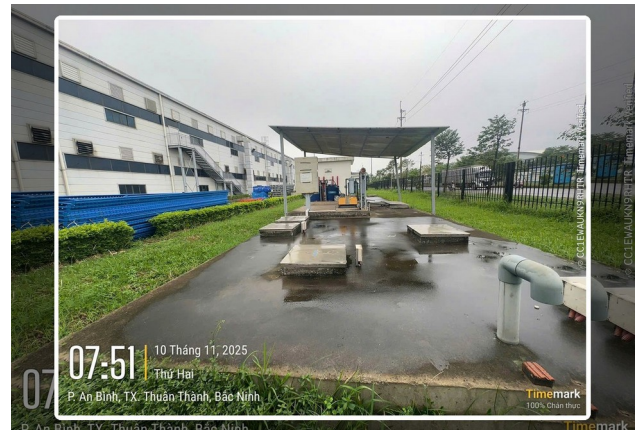
Tổng thể trạm xử lý nước thải trong khuôn viên nhà máy
