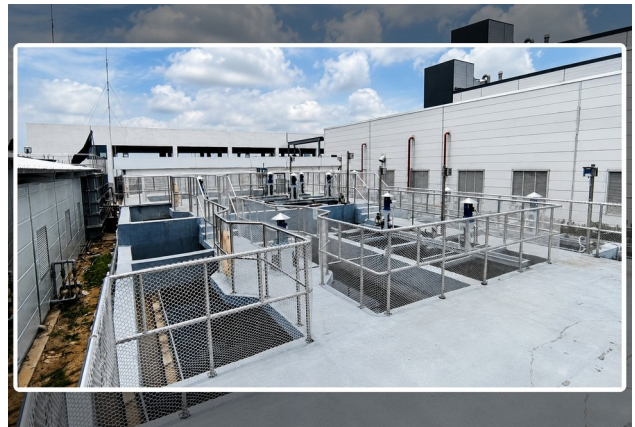
Toàn cảnh khu xử lý nước thải trong nhà máy
